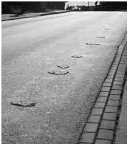
Przy skrzyżowaniu z ul. Ossowskiego asfalt faktycznie pokropiony jest betonem
